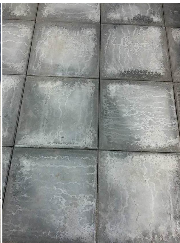
Afbeelding 2: Voorbeeld van secundaire kalkuitslag
