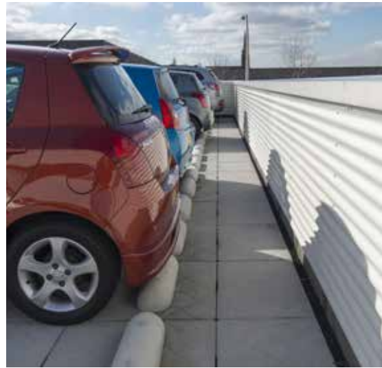
Stootbanden ter bescherming van de opstandafwerking
